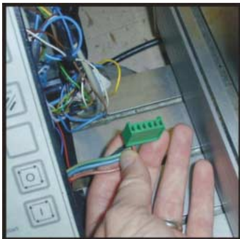
Cable Connector (Left Gantry Leg)
